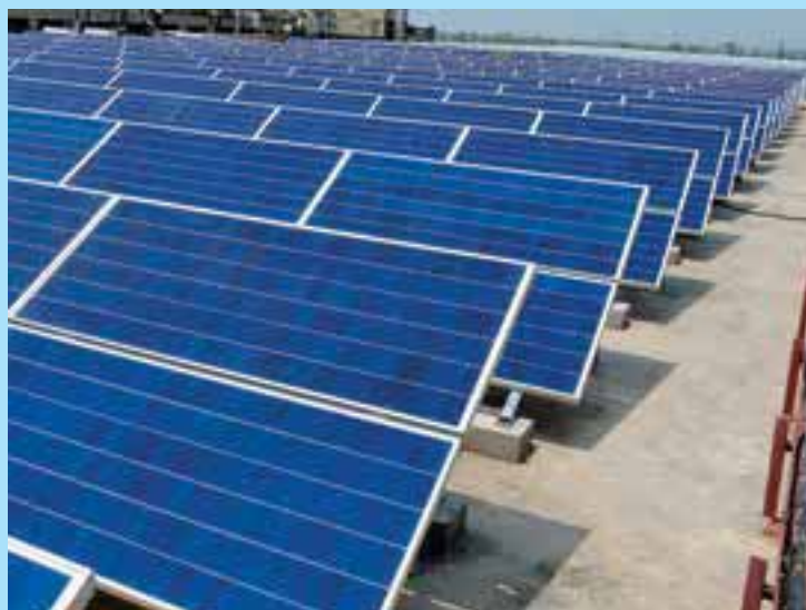
Solar Panels - 291KW
